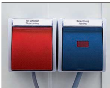
Strömbrytare för belysning och knapp för dörrspärrsystem
